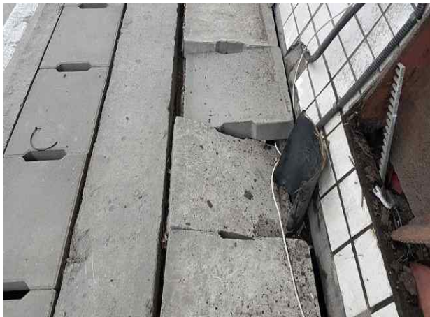
공동구 덮개 파손 및 이격
