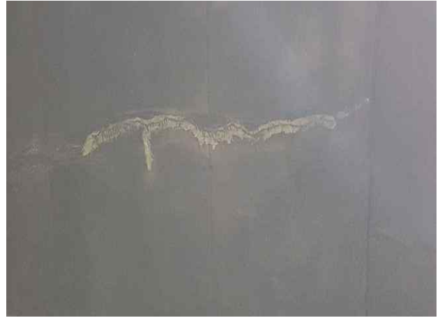
라이닝 균열 및 백태
